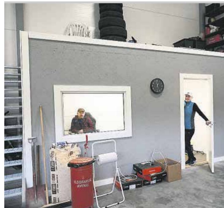
KONTOR: I bua har Terje og Nina bygd et kontor med kjøkken og toalett.
